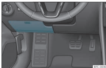
Fig. 43 Veicoli con guida a sinistra: coperchio della scatola dei fusibili sotto il cruscotto sul lato conducente
